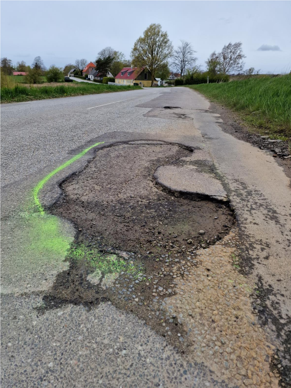
Steenstrupvej- obs stort hul
